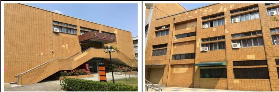
外牆磁磚剝落
