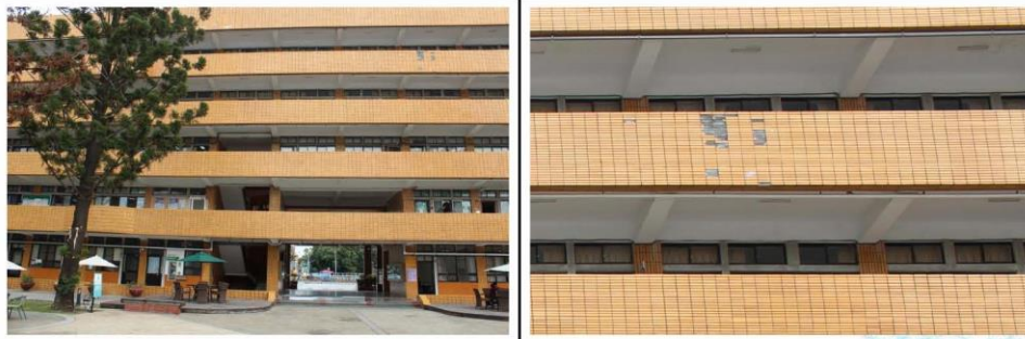
外牆磁磚剝落
