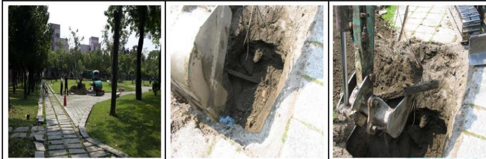
資訊圖書中心南側土丘草皮下方約2.4公尺處有廢棄物
