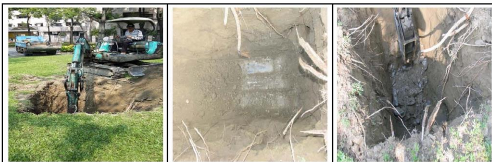
資訊圖書中心南側土丘草皮下方約1.6公尺處有混凝土地坪
