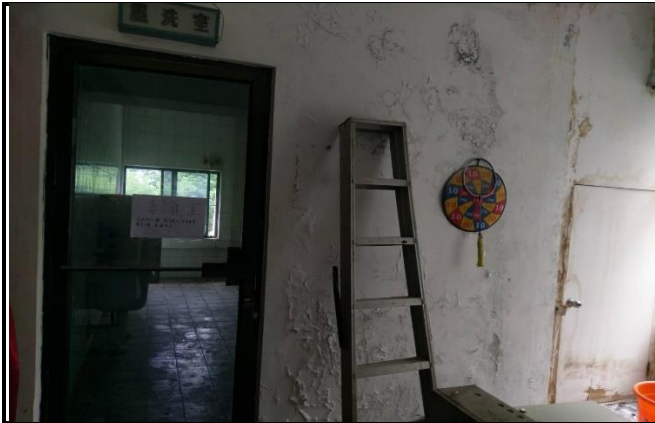
廁所嚴重漏水壁癌，排水不通引發惡臭，已封閉無法使用，需重新整修管道及牆壁
