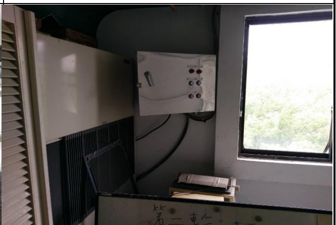
中央空調器已故障多年無法使用，已改以各空間裝設空調，需拆除空調器及管路，並整修管道間
