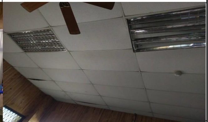
1樓系學會空間天花板嚴重變形，有塌陷危險需整修
