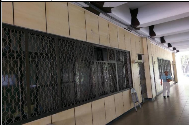
川堂隔間牆面破舊，重製牆面與窗戶
