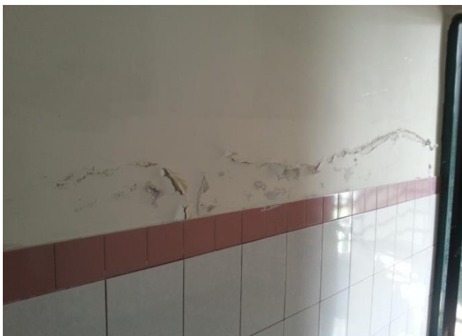
宿舍公共區域四處嚴重壁癌
