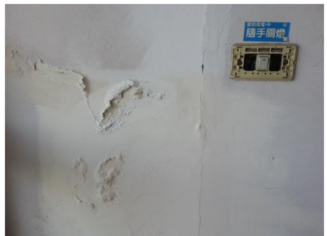
宿舍公共區域四處嚴重壁癌
