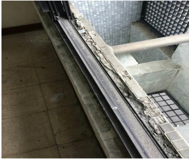
窗台磁磚嚴重脫落雨水滲進寢室
