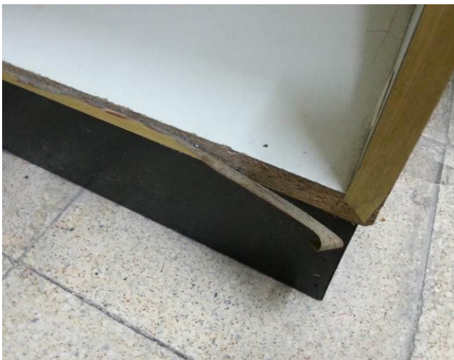
寢室床板毀損
