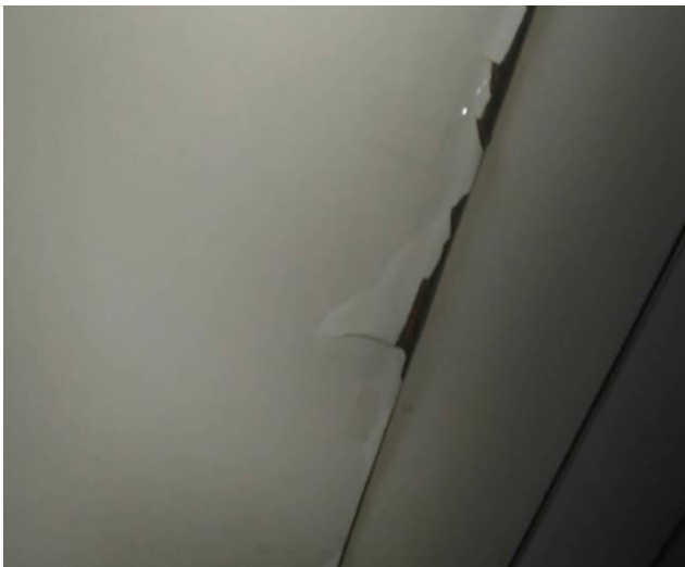
寢室內嚴重壁癌及漏水
